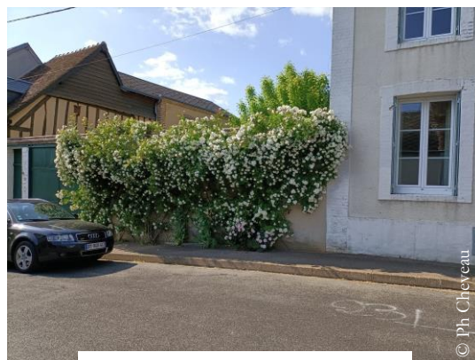
Végétation en pied de mur et façade
